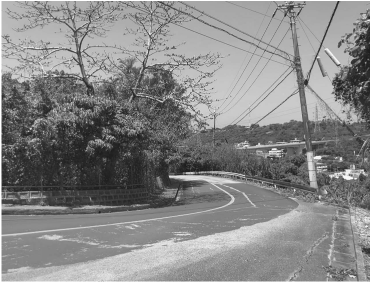
地盤沈下が確認された村道1号線
