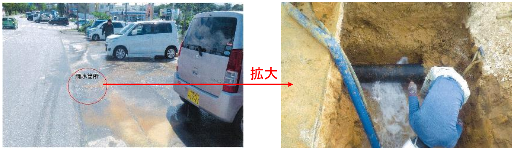
R2.9.30 Φ200mm 配水管漏水状況 リージョンクラブ前
