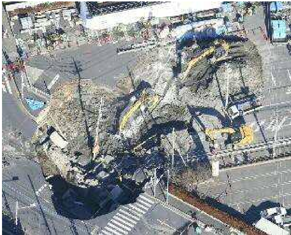
令和7年1月 八潮市（埼玉県）下水道管陥没事故 （「読売新聞オンライン」から引用）
