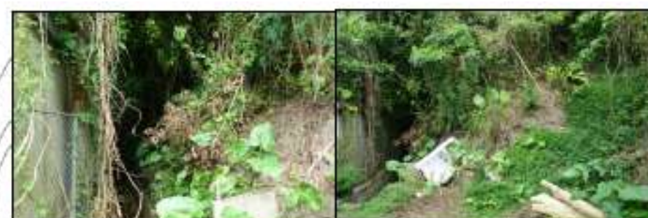
急傾斜のがけ面であり、もろい土質でもあることから、がけ面対策が必要と考えられる箇所（樹木伐採によりがけ面の崩壊などが起こりやすいと思われる）
