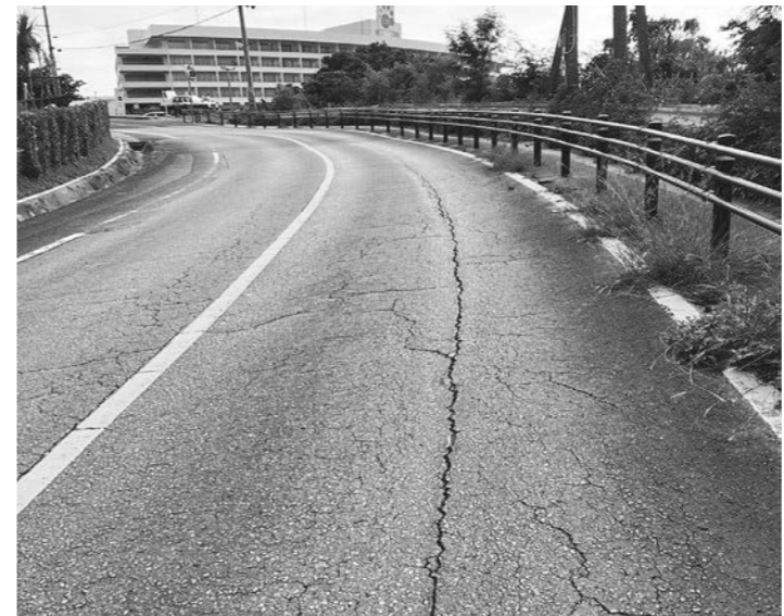
EMホテル近くの村道アスファルトの割れ目
